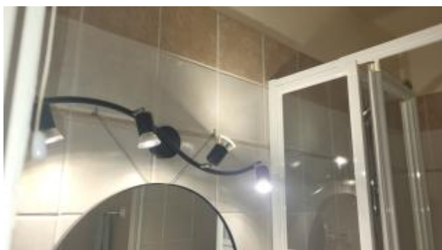
Date: 17/12/2025 Salle d'eau Rch : Point lumineux sans indication classe 2 à moins de 60 cm du bord de la douche
