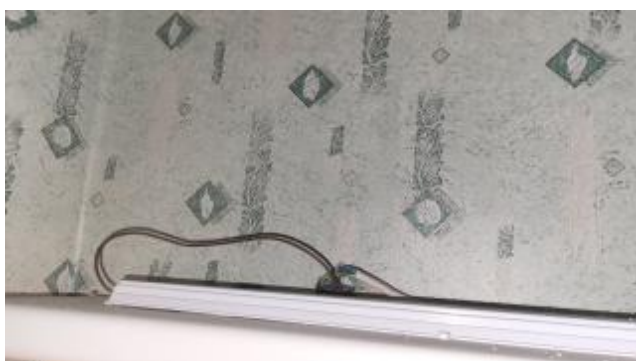
Date: 17/12/2025 Salle d'eau : Présence d'un domino non protégé par un boîtier
