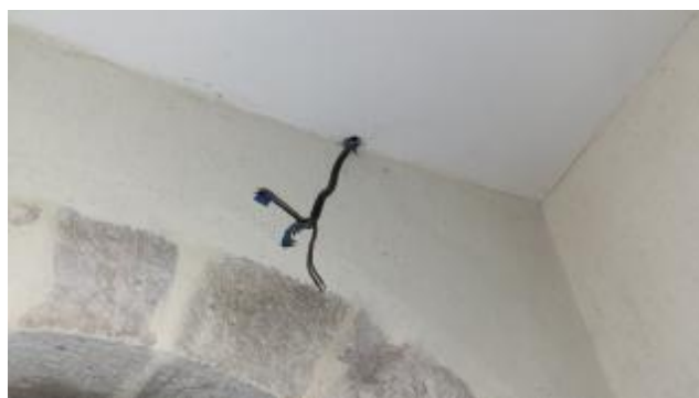
Date: 17/12/2025 Patio : Conducteur actif non protégé
