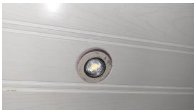
Date: 17/12/2025 Salle d'eau : Point lumineux situé dans le volume 1 de la pièce.
