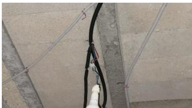
Date: 17/12/2025 Dégagement 1 : Présence de dominos on protégés par un boîtier
