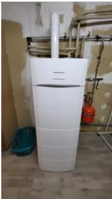
Date: 17/12/2025 Chaudière individuelle gaz
